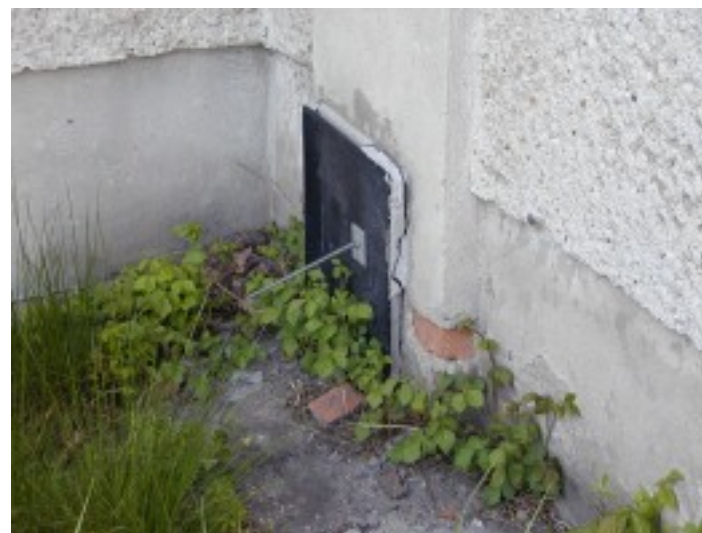
Zdjęcie 10 Prowizoryczne drzwiczki wyczystki kominowej.
