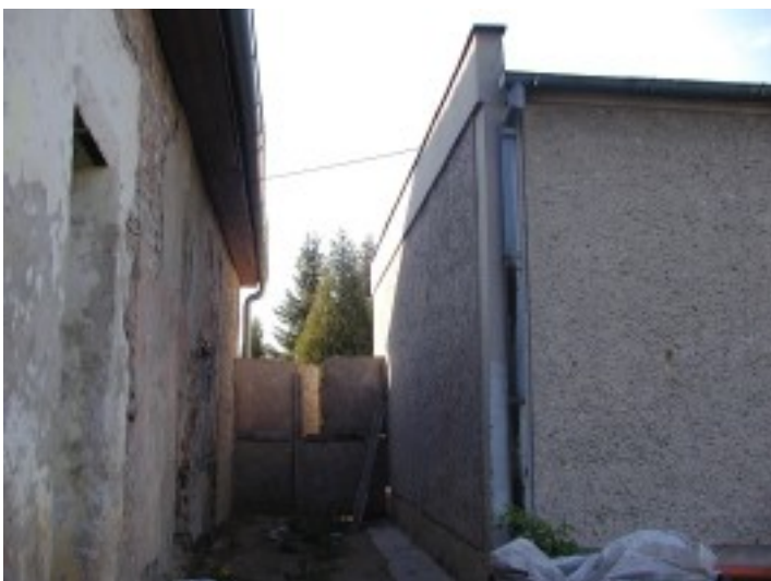
Zdjęcie 5 Widok budynku od strony bocznej, korozja rury spustowej i rynny.
