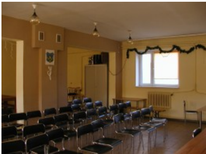
Zdjęcie 12 Widok sali świetlicy, wyeksploatowana instalacja c.o.
