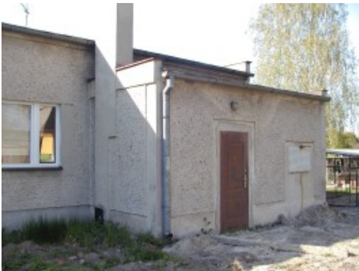
Zdjęcie 4 Widok budynku od strony tylnej- niższa część, brak opaski budynku.
