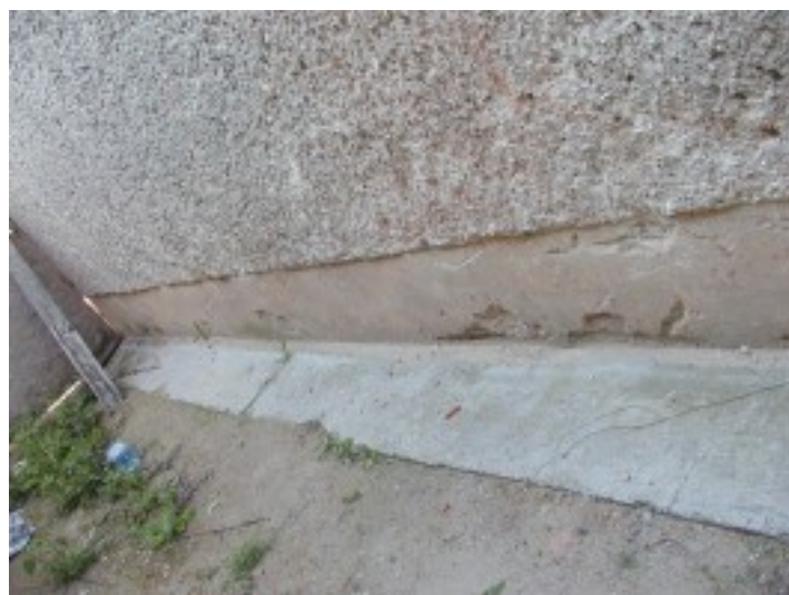
Zdjęcie 9 Ubytki tynku.
