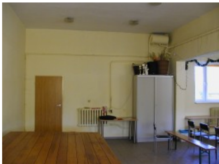
Zdjęcie 13 Widok sali świetlicy, wyeksploatowana instalacja c.o.
